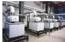
Вакуумная установка электронно-лучевой сварки
